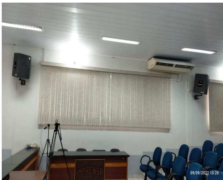
02 Caixas de som do lado da mesa de imprensa para manutenção.
